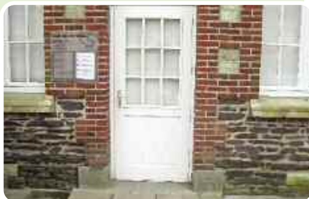
Les marches aux entrées de l'Espace Chateaubriand ont été effacées
